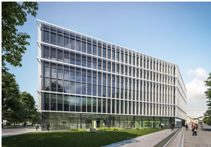
Abb.: Am Netz-Gebäude des Unternehmens, das derzeit gebaut wird, wird eine Photovoltaik-Fassade erreicht. Für die Ausführung der Fassade wurde ein sehr flexibel gestaltbares PV-System geplant. Die Fassade befindet sich kurz vor Fertigstellung. (Fotocredit: ZOOM VP.AT)
