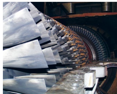
Turbinenschaukeln Energiepark Linz-Süd
