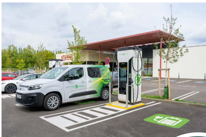
Die Schnellladestationen beim PRO-Kaufland werden gut angenommen. Seit August ist der Ladepark im Vollbetrieb.
