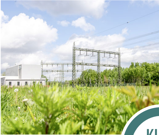
Das Umspannwerk Pichling ging nach seinem Umbau Ende April in Betrieb.
