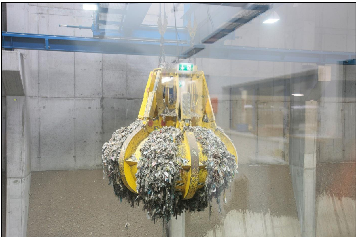
Abb. 77: Greifer im Bunker
